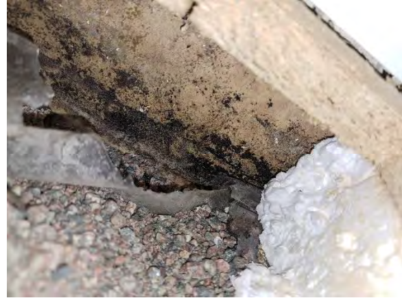
Foto 13 synliga mögelskador på gipsskiva i golvet
