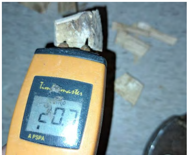
Foto 19 fuktmätning underkant syll över kritisk nivå
