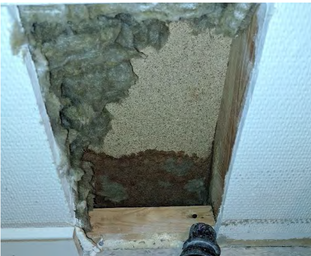
Foto 18 öppnad innervägg med fuktuppsug
