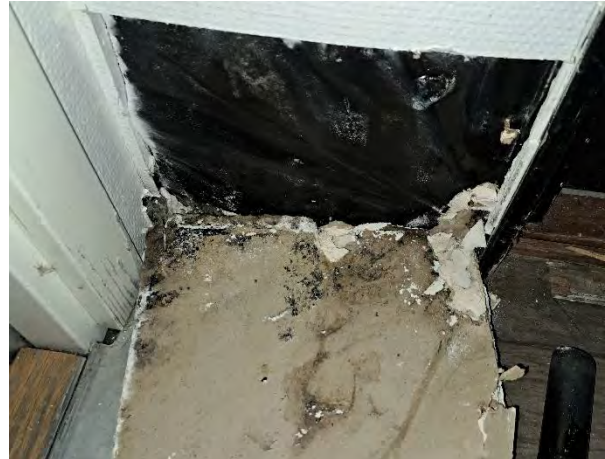
Foto 10 mögelskador baksida gipsskiva
