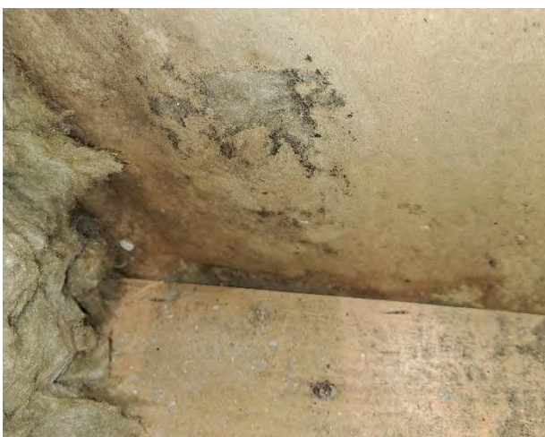
Foto 11 synliga mögelskador insida GNU skivan
